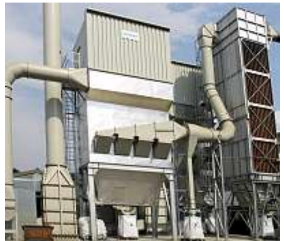
Luft-Luft-Wärmetauscher und Scheuch-IMPULS-Filteranlage
