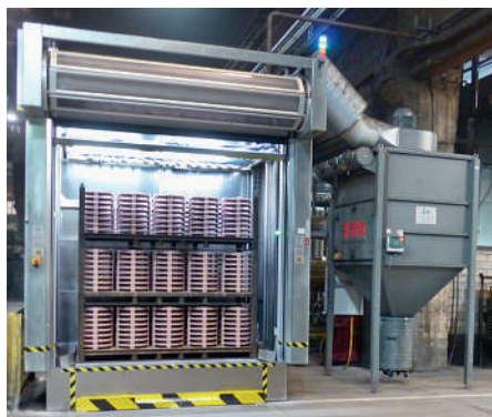
Innovation in Eigenentwicklung: Die neue Kernreinigungsanlage
