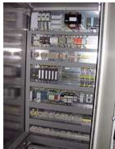
Bild 4: Umrichtersteuerung der Neuanlage bei der Fa. Bruzaholm
