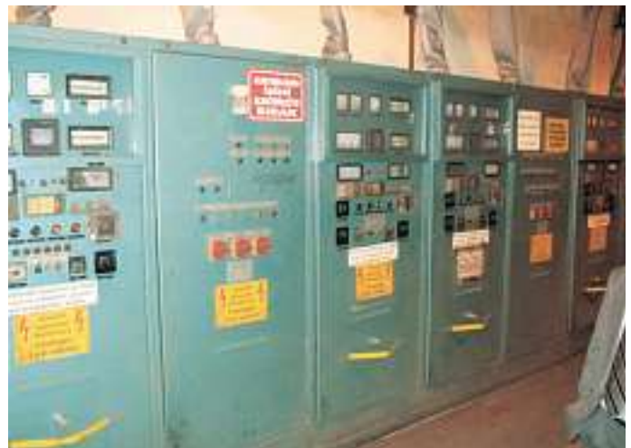
Bild 5: Vorher – Vorhandene Anlagensteuerung bei der Fa. E.G.O.
